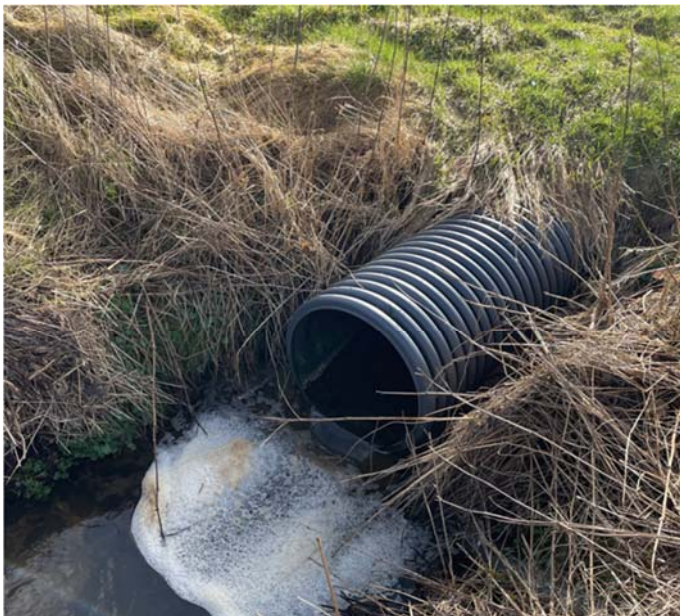
Figur 5 - Styrt ud af eksisterende rørunderføring i st. 702-705
